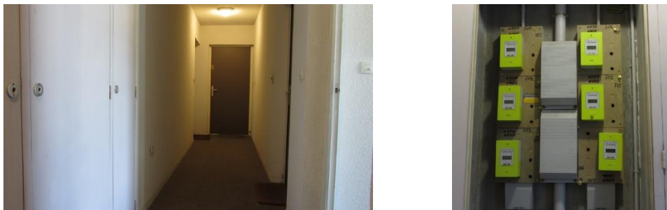
Figure 1 : couloir du deuxième étage (l'appartement est celui au fond à gauche) ; les compteurs Linky G3 des six appartements de l'étage sont situés dans le couloir.
