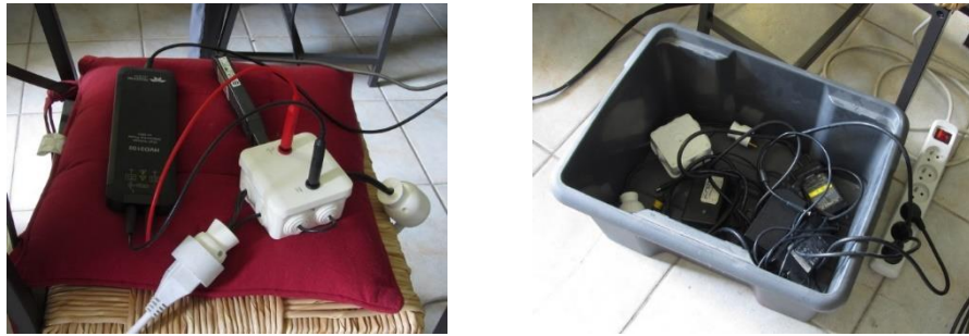
Figure 2 : sonde de courant et chargeurs électroniques (charges capacitives).
